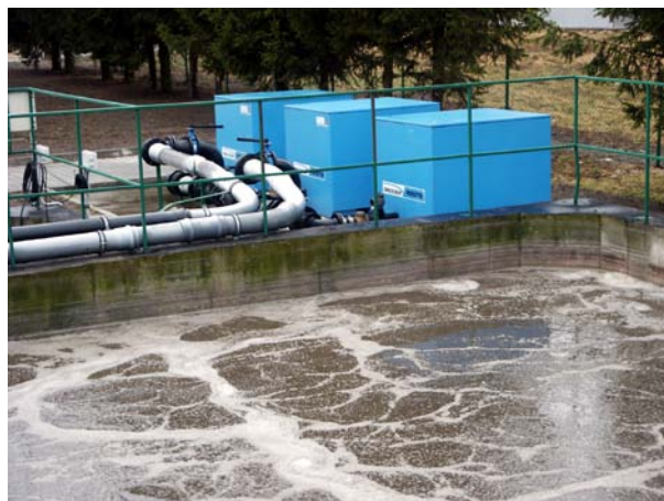
fot. 4 Oczyszczalnia ścieków w Sępólnie
